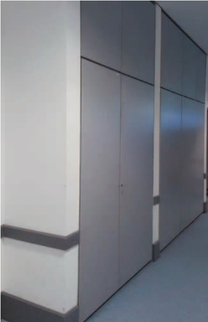
Vor der Sanierung – Abtrennung ohne Feuerwiderstandsfähigkeit
